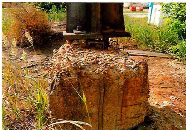
▲ Примеры разрушений и повреждений железобетонных конструкций трубопроводных эстакад в АО «АНХК» ▲ Examples of destruction and damage of the pipe racks reinforced concrete structures in AO ANKHK
