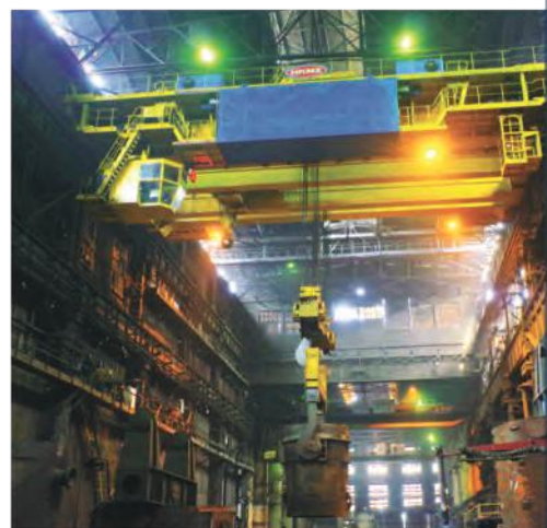
Крани мостові електричні
