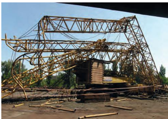
Рис. 6 Последствия аварии крана МКТ – 250
