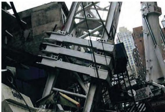
Падение башенного крана в результате недостатков в креплении башни к зданию (анкерные стяжки воспринимали только боковые нагрузки, но не воспринимали гравитационные нагрузки от собственного веса крана)
