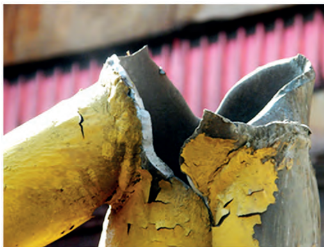
Рис. 4 Место первоначального разрыва сварного соединения ремонтной вставки металлоконструкции стрелы
