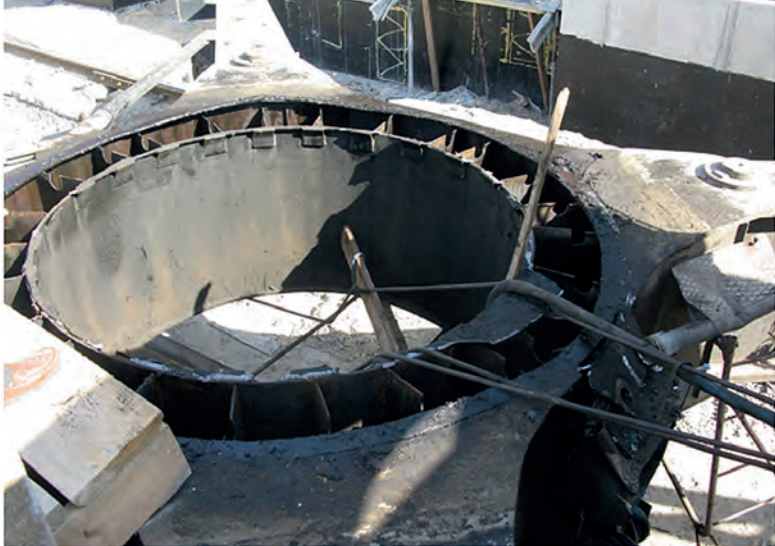
Разрушение верхнего листа ходовой рамы. Полный отрыв башни «по-живому» металлу с наружной стороны и сварному соединению с внутренней стороны.
