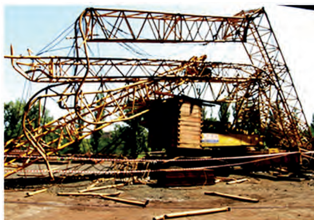
Рис. 3 Последствия аварии крана МКТ – 250
