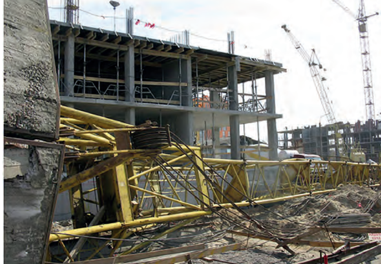
Падение башни крана КБ 403 вдоль кранового пути (г. Киев).
