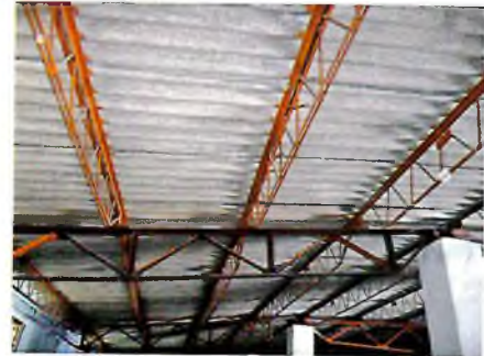
Фото 1. Деформации (прогибы) стержней верхнего пояса стропильной фермы при внеузловом опирании прогонов
